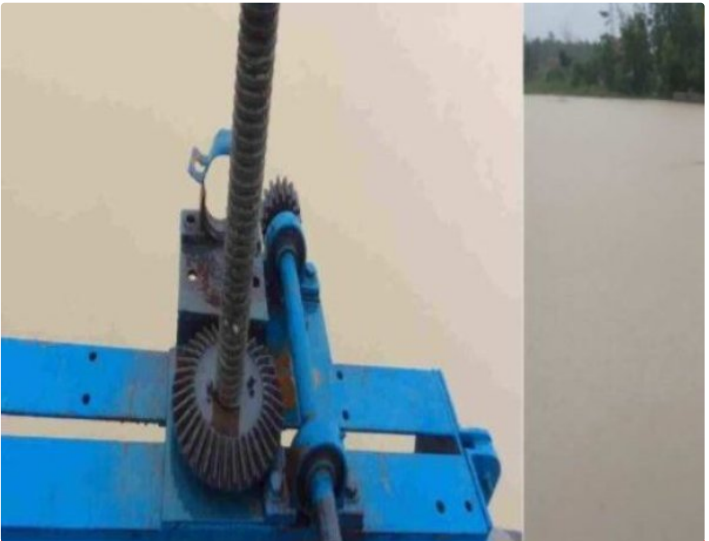
Pintu air Albaret Simpang Mesuji
